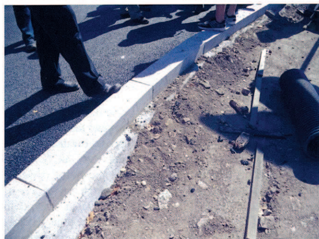
Obr. 2 Nedostatečná boční opěra
