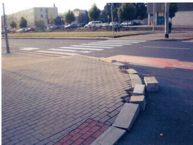
Obr. 1 Uvolněná masivní kamenná obruba (Praha, Poděbradská)
