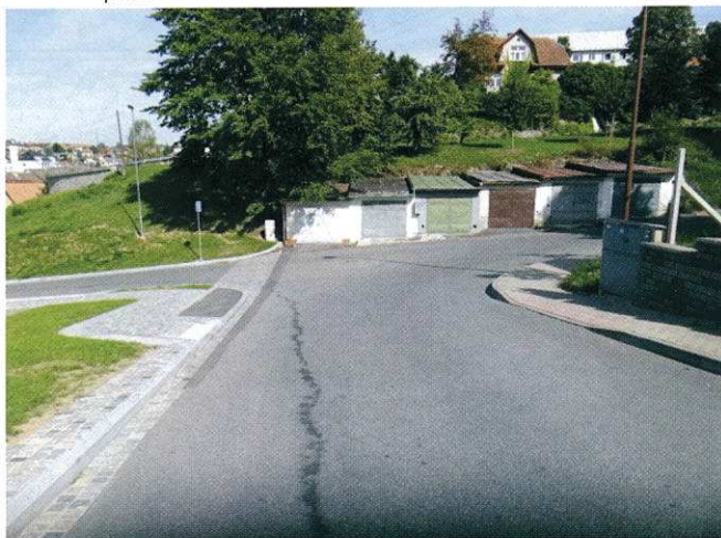
Obr. 9 Dva odlišné konce místa pro přecházení – vpravo typický s nevhledně „polámanou“ obrubou
