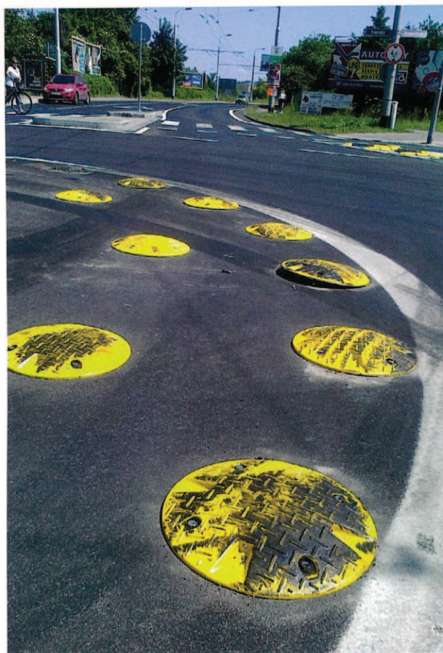
Pardubice, U Kalvodů – Polštáře uvolněné torzním namáháním
