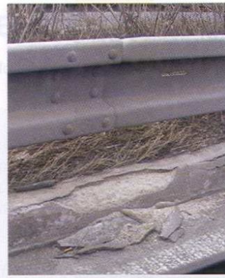
Obrázek 13: Betonový obrubník, degradovaný působením solného roztoku a mrazu, Pražský okruh, Štěrboholská radiála
